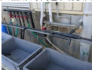
図 4 蛇口からの配管
