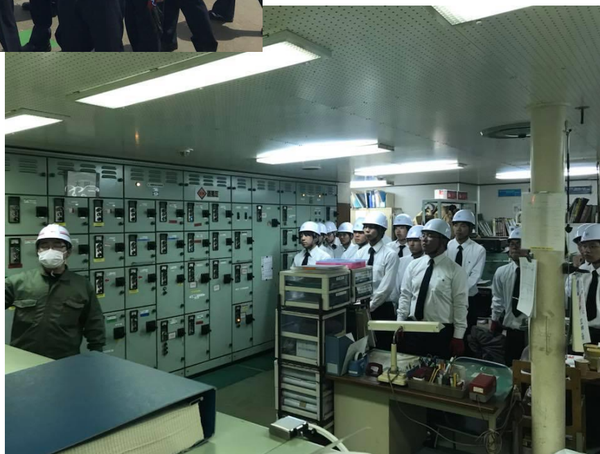
デッキと制御室の様子
