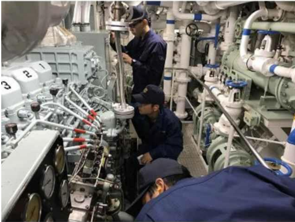
発電機運転準備中
