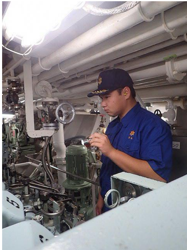
機関室にて。専攻科生が発電機の点検をしている様子です。
