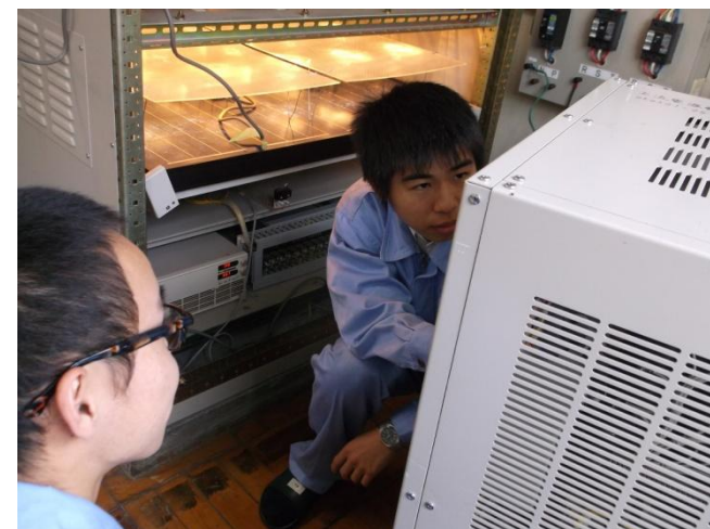
太陽光発電実習 (多結晶シリコンパネル)
